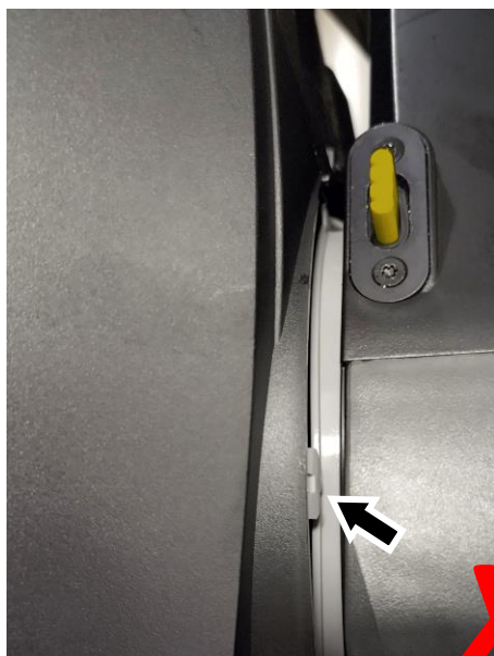
Incorrect – onglet à l'extérieur
